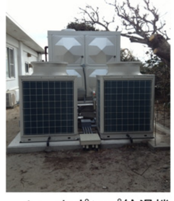
ヒートポンプ給湯機
