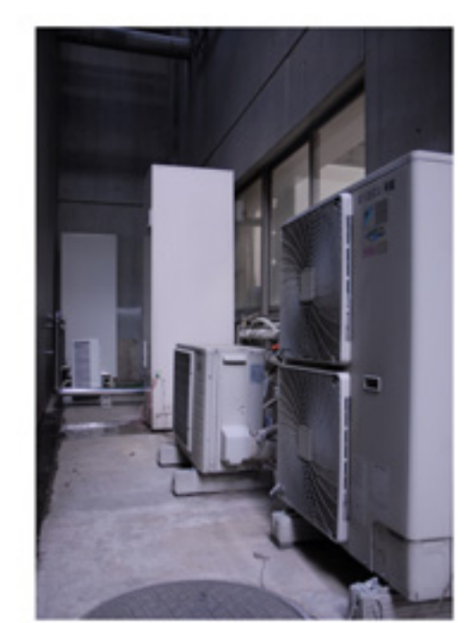
ヒートポンプ給湯機
