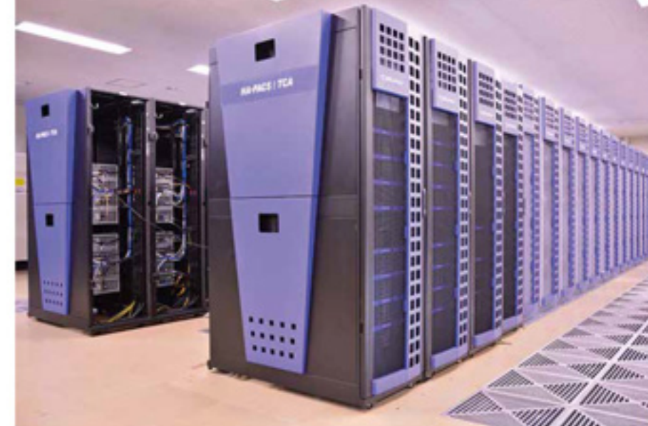
HA-PACS/TCA の写真 (手前 5x2 ラック、筑波大学)
